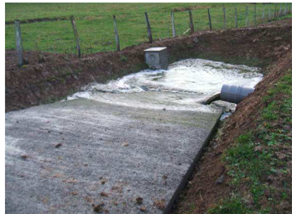
Zone en cours d'alimentation La dalle permet l'accès au tracteur pour l'évacuation Le drain du fond est protégé contre les coups de godets
