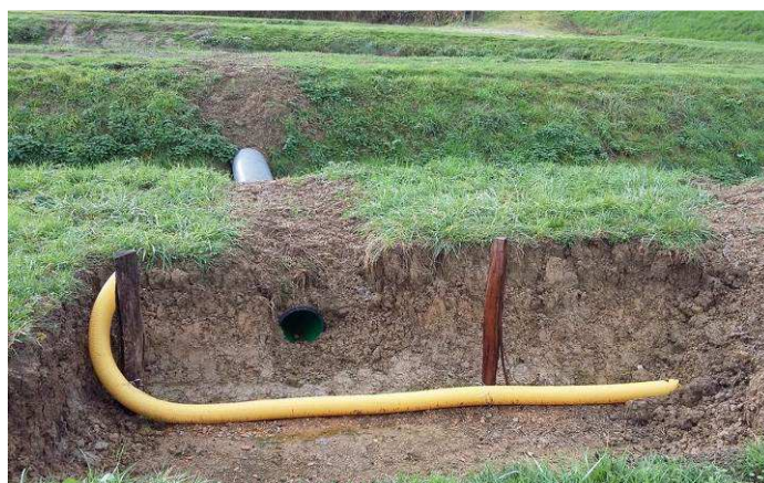
Fosse sommaire de réception des lentilles, avec drain. Canalisation d'arrivée diamètre 300 mm
