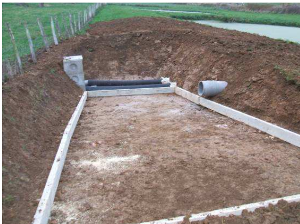
Zone de récupération des lentilles Drainage au fond avec regard NB : la dalle béton n'est pas encore coulée
